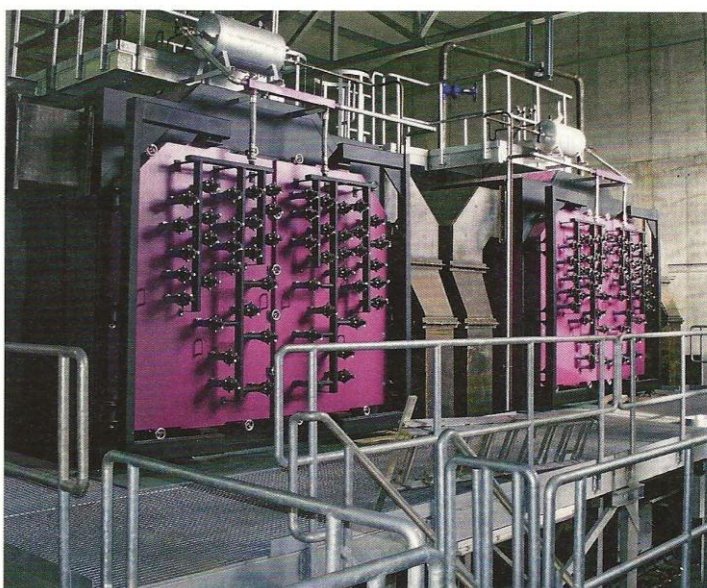
Saubere Sache: Blick in das Innere einer Biomasse-Heizzentrale.
